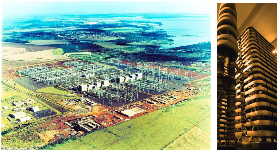
Figura 13 – Subestação de elevação e conversão ca-cc em Foz do Iguaçu- PR e quadriválvulas do sistema.
