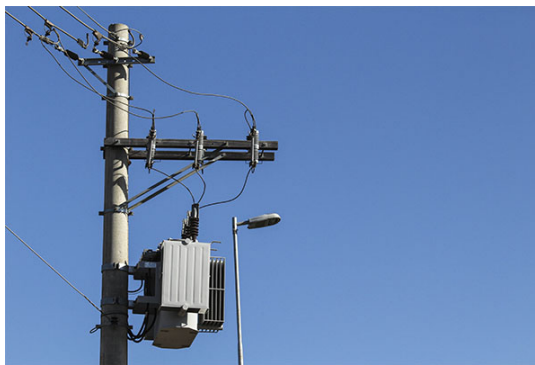
Figura 15 – Exemplos de transformadores de distribuição.
