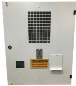
Quadro de medição
