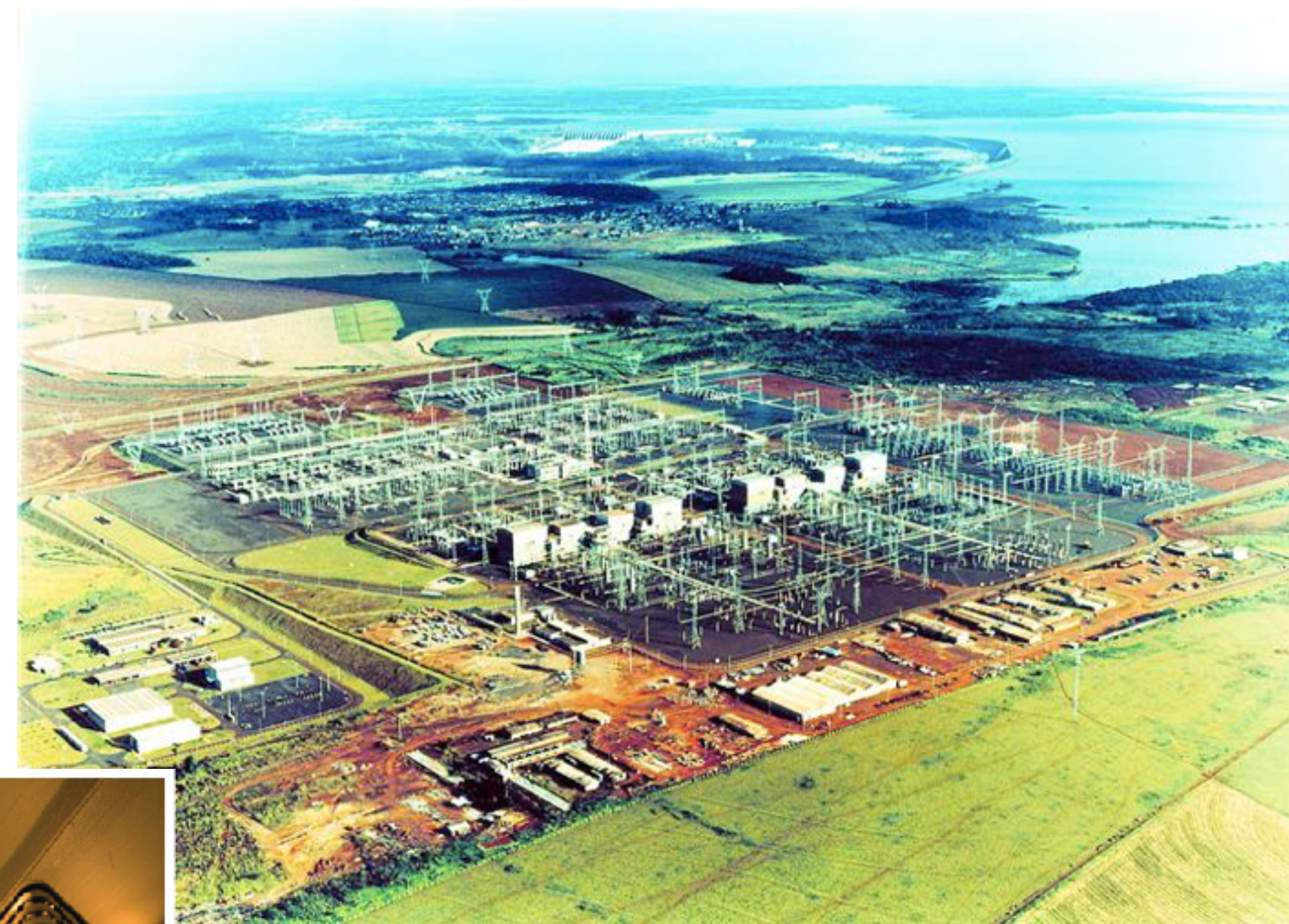
Subestação de Foz do Iguaçu
