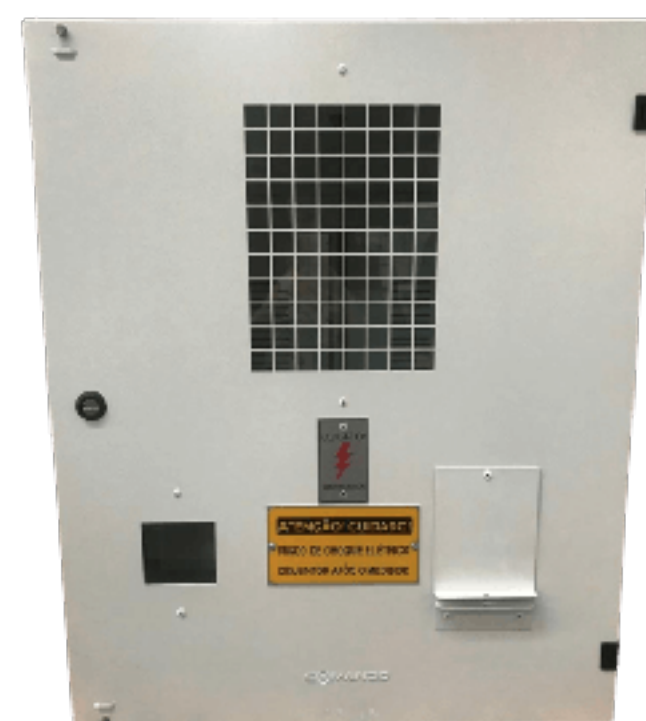
Quadro de medição
