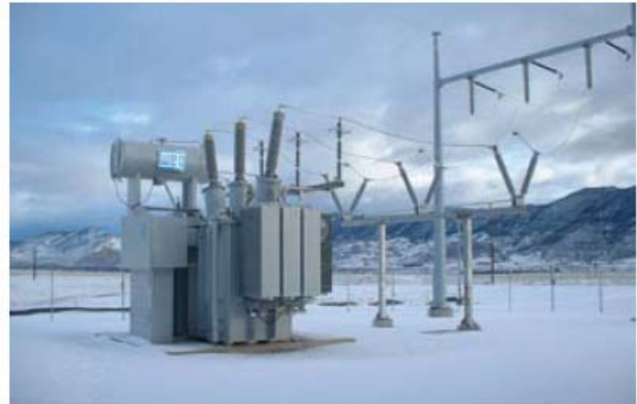
Solar Turbines - EUA Transformador 75 MVA - 169 kV
