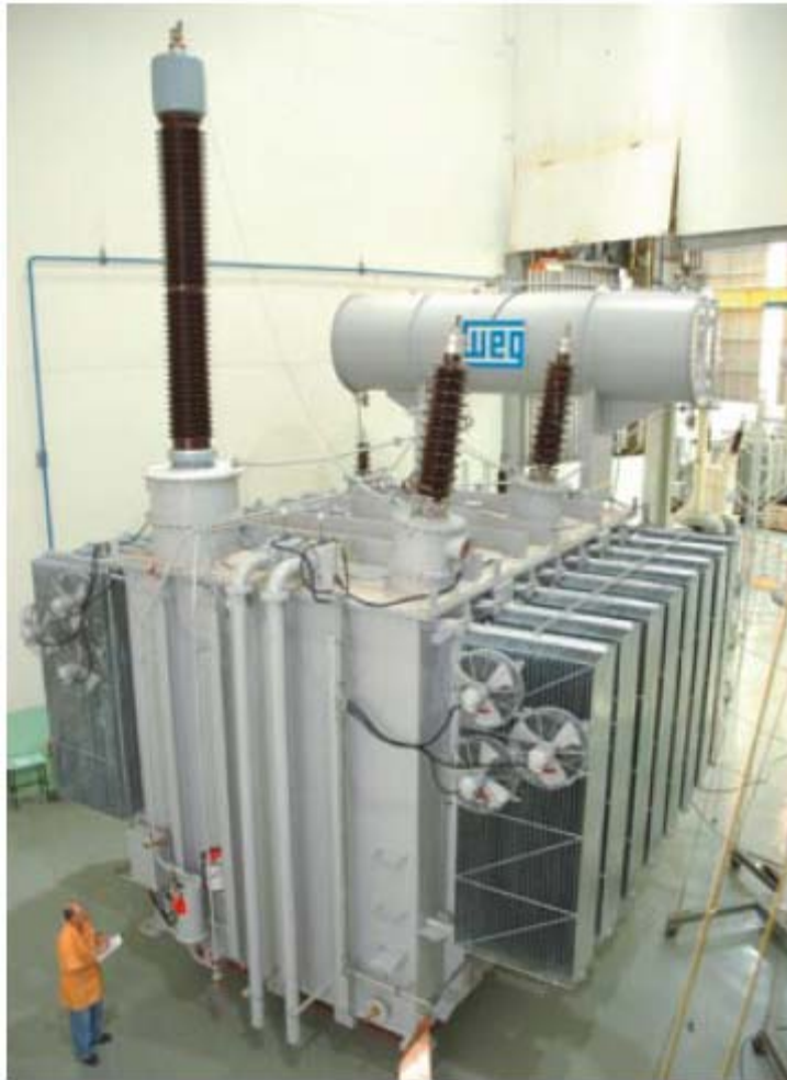
Alusa S.A (CTEP) - SE Balxada Santileta Transformador 133,3 MVA - 362 kV - Monofásico (04 peças)
